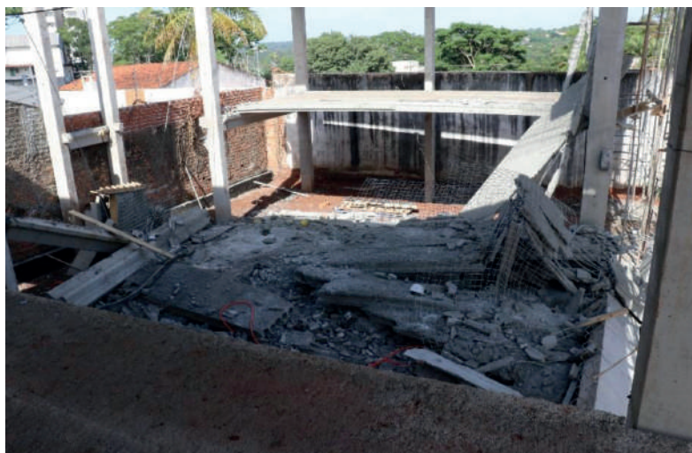
Figura 3. Desabamento de estrutura e animação. Fonte: Wissmann et al (2023)
