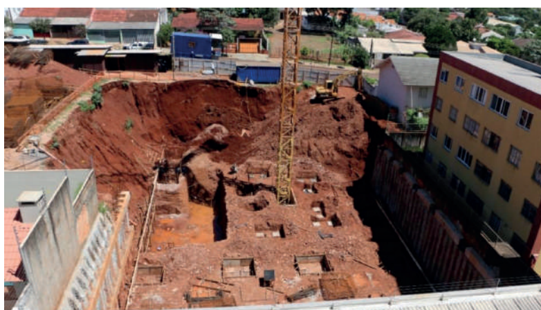
Figura 4. Deslizamento de terra em escavação a céu aberto e animação. Fonte: Venson et al (2019)
