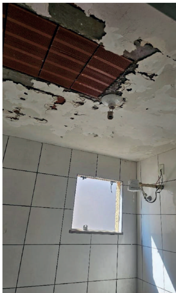
Manifestação patológica decorrente de falta de manutenção
