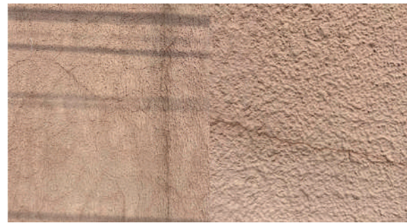
Figura 3. Fissuras mapeadas em fachada emassada (Imagem aberta e fechada)
