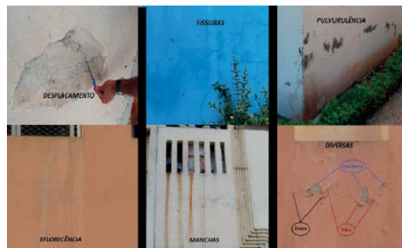
Figura 1. Quadro de patologias. Fonte: SANTOS, D. G. (2018)
